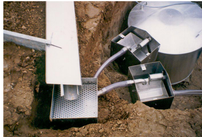
RUN-OFF MESSEINRICHTUNG - zur Erfassung und automatisierten Beprobung von Oberflächenabfluss. Einlaufsystem, Kippzähler, mikrorechner-gesteuerter Autosampler.
